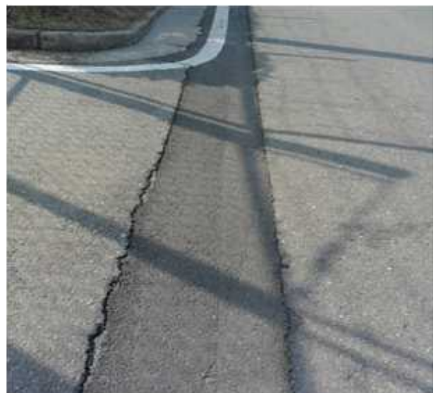
<Figure 7> 침하부 중복포장에 의한 Crack 및 침하
