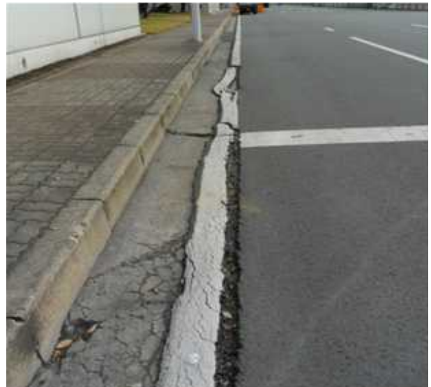
<Figure 6> 중복포장을 통한 표층 탈락
