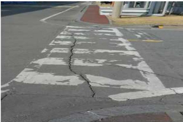
<Figure 4> 횡단보도의 온도균열
