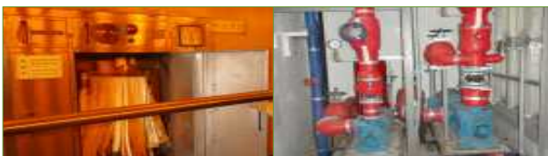
〈Figure 14〉 Fire hydrant
