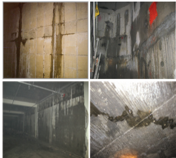
사진 1. 콘크리트 구조물의 누수 현상
