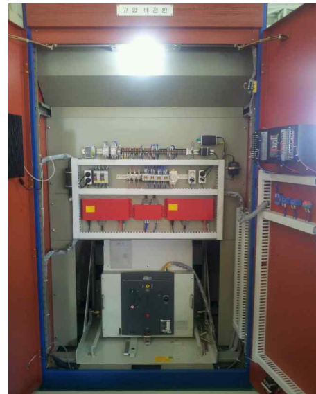
사진 1. 합체내부에 장착된 VPN 이중화 시스템 Photo 1. Soft-redundant VPN system installed within the panel
