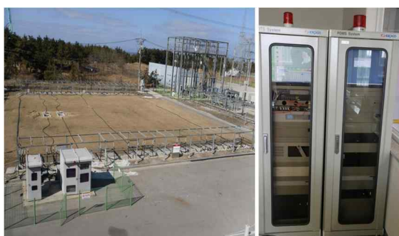
그림 2. 실시간 감시시스템 실증시험장 Fig. 2. Test-bed of OFCPC on-line monitoring system
