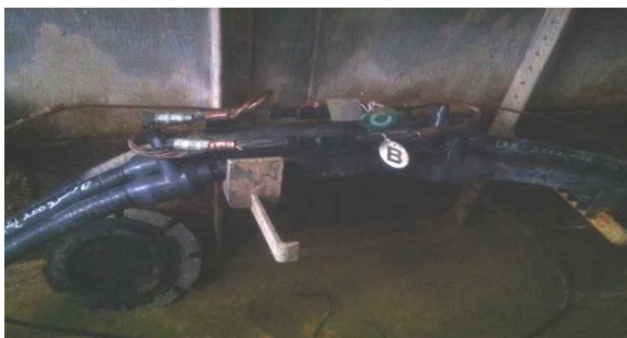
그림 3. 맨홀 내 지중 배전케이블 직선접속 Fig. 3. Splice of distribution power cable in Manhole
