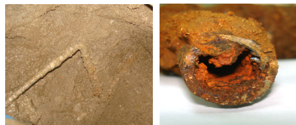
Fig 1. 주택 벽체에 부설된 노후관 전경(좌) 및 관 단면(우)
