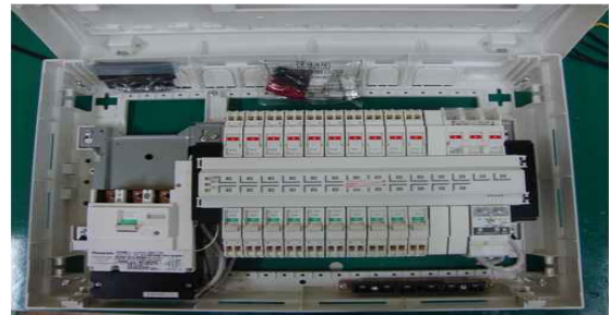
그림 1. 상하 배열의 분전반 [일본] Fig 1. Distribution panel of vertical array(japan)
