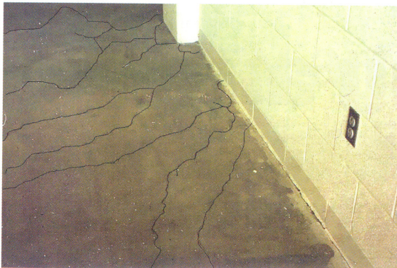
〈그림 2〉 지주 조기제거로 인한 균열
