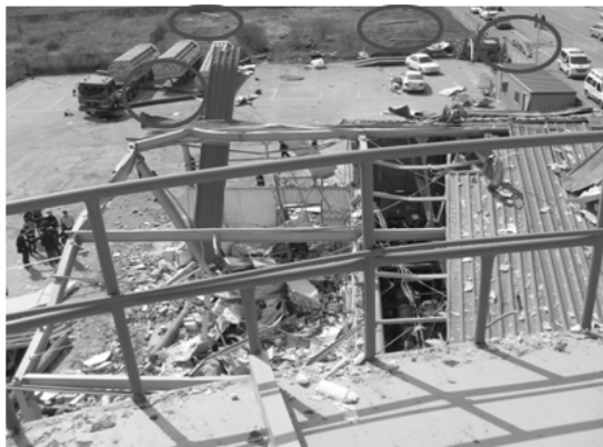
사진3 : 폭발로 비산한 수소 실린더
