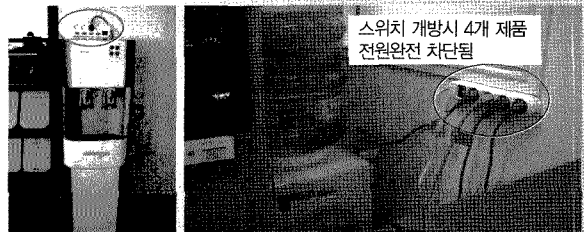
【사진 9, 10】 정수기와 냉·온수기 전원차단용 2극 스위치부 멀티 탭
