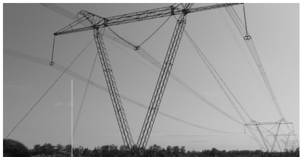
카자흐스탄 1150kV 송전선로
