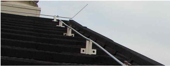
그림 11. 금속기와지붕 경사면에서의 피뢰도선 시공 사례 Fig. 11. Picture of air-termination system installed at the slop of roof
