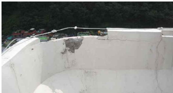
그림 1. 공동주택 지붕의 낙뢰피해 사례 Fig. 1. Lightning damage occurred at the apartment roof
