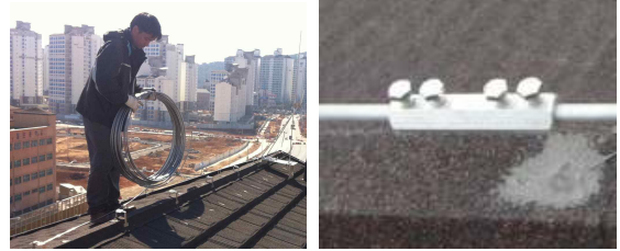
그림 13. 피뢰도선의 시공 및 접속 상태 Fig. 13. Picture of air-termination system installation and connection of conductors
