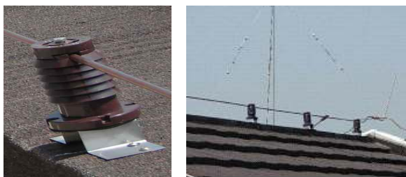
그림 3. 금속기와에 설치된 기존 수평도체지지대 Fig. 3. Conventional of air-termination conductor supports installed on the metal roof
