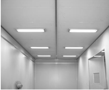
a) 매입형광등 설치전경: 적합
