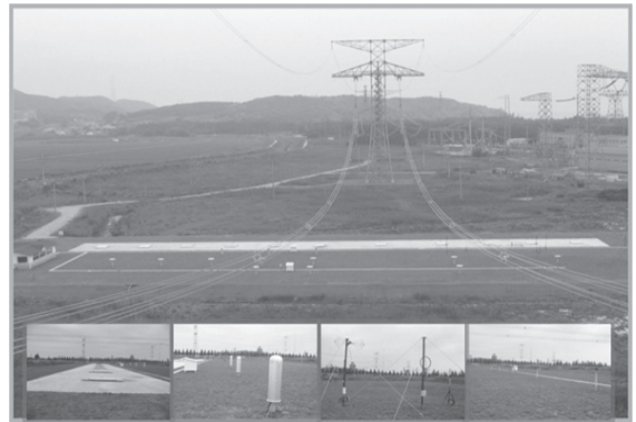
〈HVDC 선로 실증시험〉
