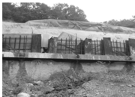
(b) 강재 버팀띠장 파손
