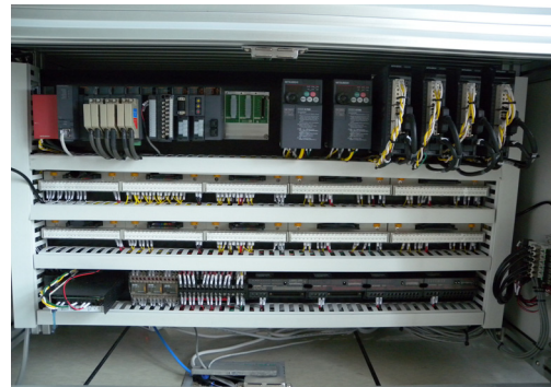
그림 7 실습장비 제어반 Fig.7. Control panel of practice Equipment
