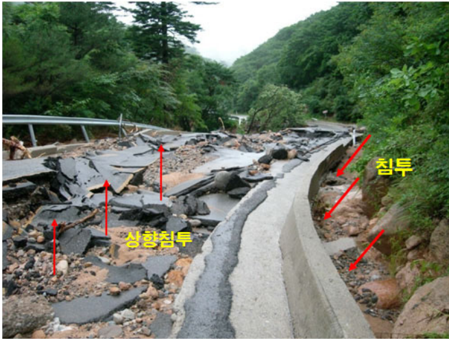
그림 1. 상향침투수압에 의한 포장 들림 파손(국토해양부, 2007)
