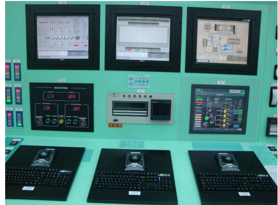
그림 7. 운전 조작반 설치 사진 Fig. 7. The Picture of Operation Console
