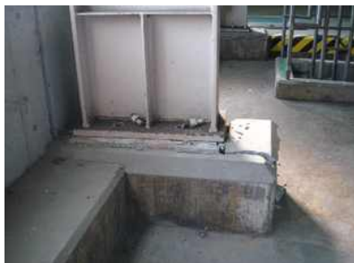
사진 1. 가시와자키 가리와 원전 변압기 정착부 앵커의 전단파괴
