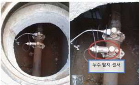
그림 2. 상수도관에 설치된 누수 탐지 센서 Fig. 2. Water leak detection sensor installed on pipe.
