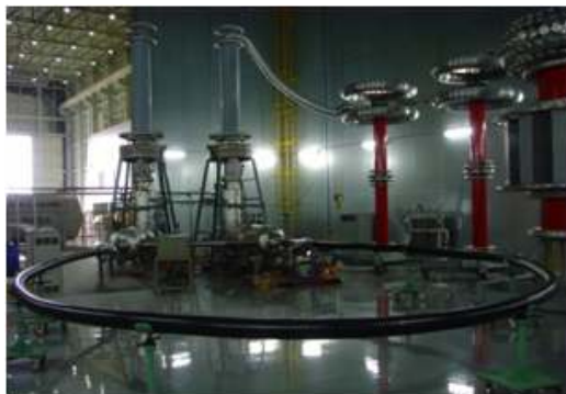
그림 4. 실드룸내에 설치 시험중의 154kV, 1GVA급 30m 케이블.
