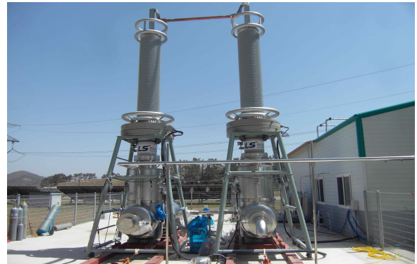
그림 1. 154kV, 1GVA급 초전도케이블용 단말.
