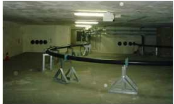
그림 5. 지하 전력구에 설치된 154kV, 1GVA, 100m 초전도케이블.
