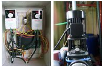
그림 4. 인버터 및 블루트 펌프
