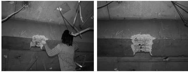
(a) 균열 검사 (b) 보에 발생한 균열 현황
