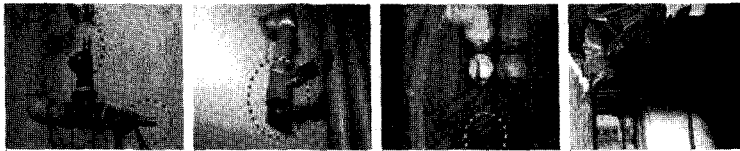
호스 철거 후 막음 미조치 연소기 철거 후 밸브 막음 미조치 연소기 철거 후 호스 상태 방치 막음조치 안된 시설에서 화재발생
