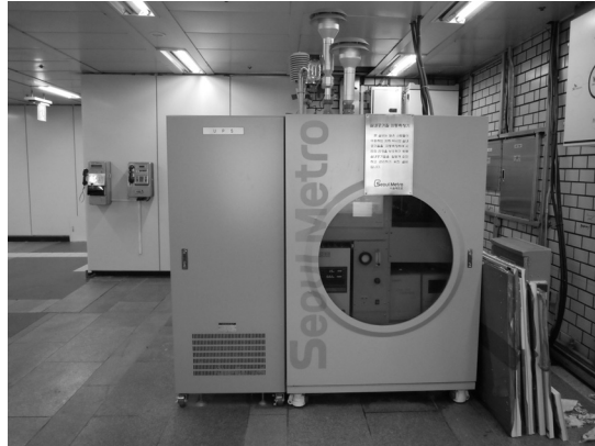
(b) 대합실에 설치된 TMS 측정기
