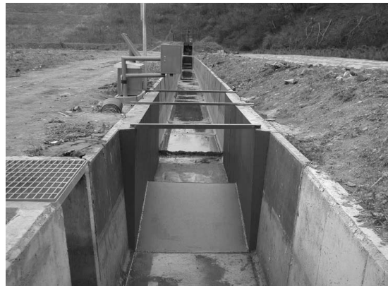
그림 1. 용덕간선에 설치된 2차원 3단면 위어
