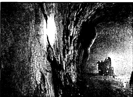
그림 4. 중국 쓰촨성 야룽강의 JinPing II hydroproject에서 터널 어깨부의 암반파쇄
