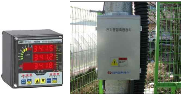
그림 3. PQ Meter 및 외함 Fig. 3. PQ Meter and case
