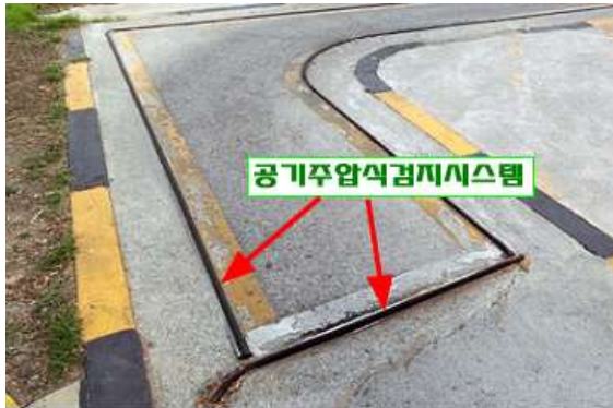
그림 1. 공기주압식 검지시스템 Fig 1. Sensing System of Air Pipe Way
