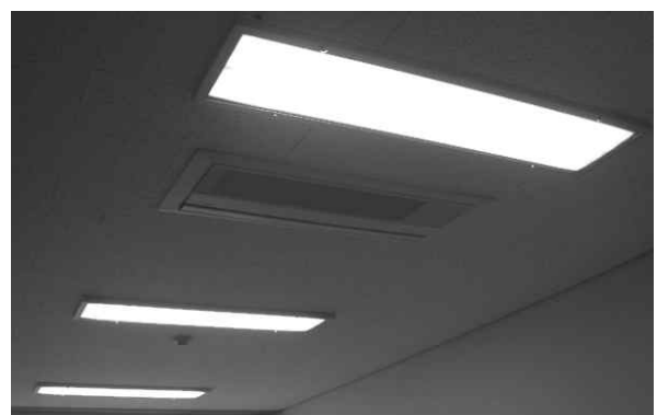
그림 4. 실험실의 천정에 설치된 조명
