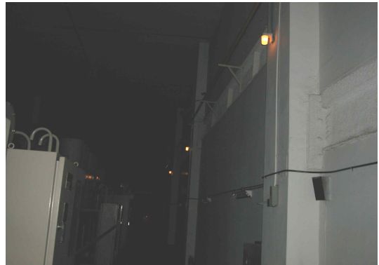
그림 4. 백열등 비상조명등이 설치된 기존 모습 Fig. 4. The existing scene of installed emergency lamps of incandescent lamps
