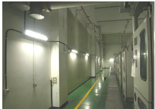
그림 5. AC/DC겸용 비상 및 복구등을 설치된 모습 Fig. 5. The scene of installed the AC/DC combination emergency and recovery lamps
