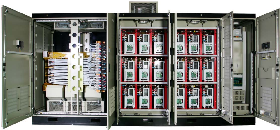
그림 7 실험에 적용된 H-브릿지 멀티레벨 인버터 Fig. 7 6600V 2000kVA H-bridge multilevel inverter hardware used for experimental evaluation
