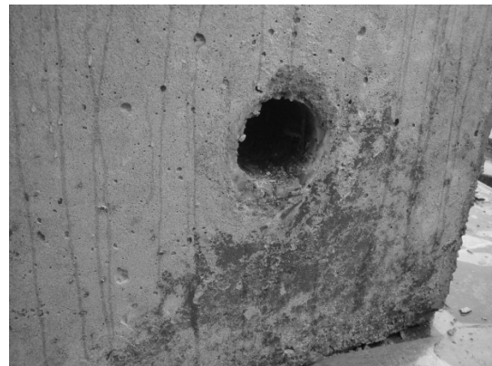
(b) 해체후 시공이음부 접합면에 grease가 남아 있는 모습
