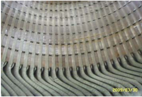
그림 6 고정자 권선 오염 및 손상상태 Fig. 6 The status of pollution and damage of stator winding
