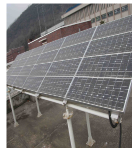
(b) 태양전지 어레이 (b) Photovoltaic cell array
