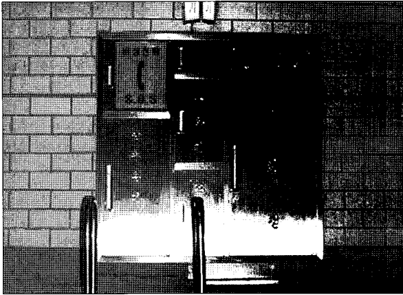
그림 2. 터널내 설치된 소화전 사진
