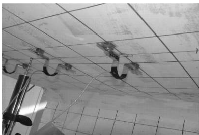
Photo 2 균열게이지 부착 전경
