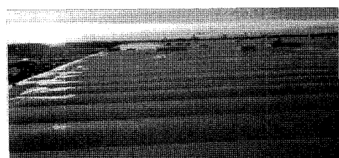
그림 3. 강풍에 의한 지붕 마감재의 들뜸 현상
