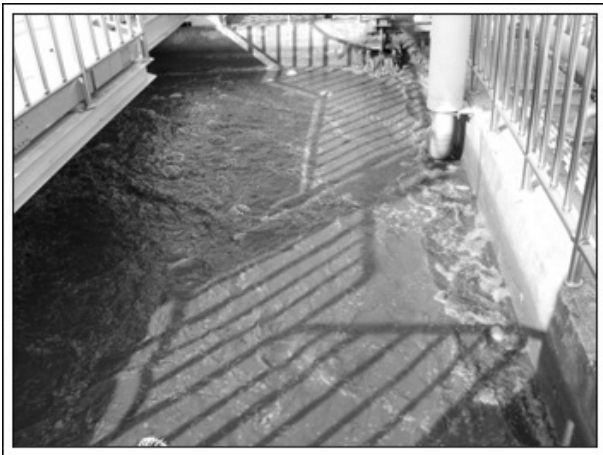
사진 1. 영동군 공공하수처리시설 생물반응조
