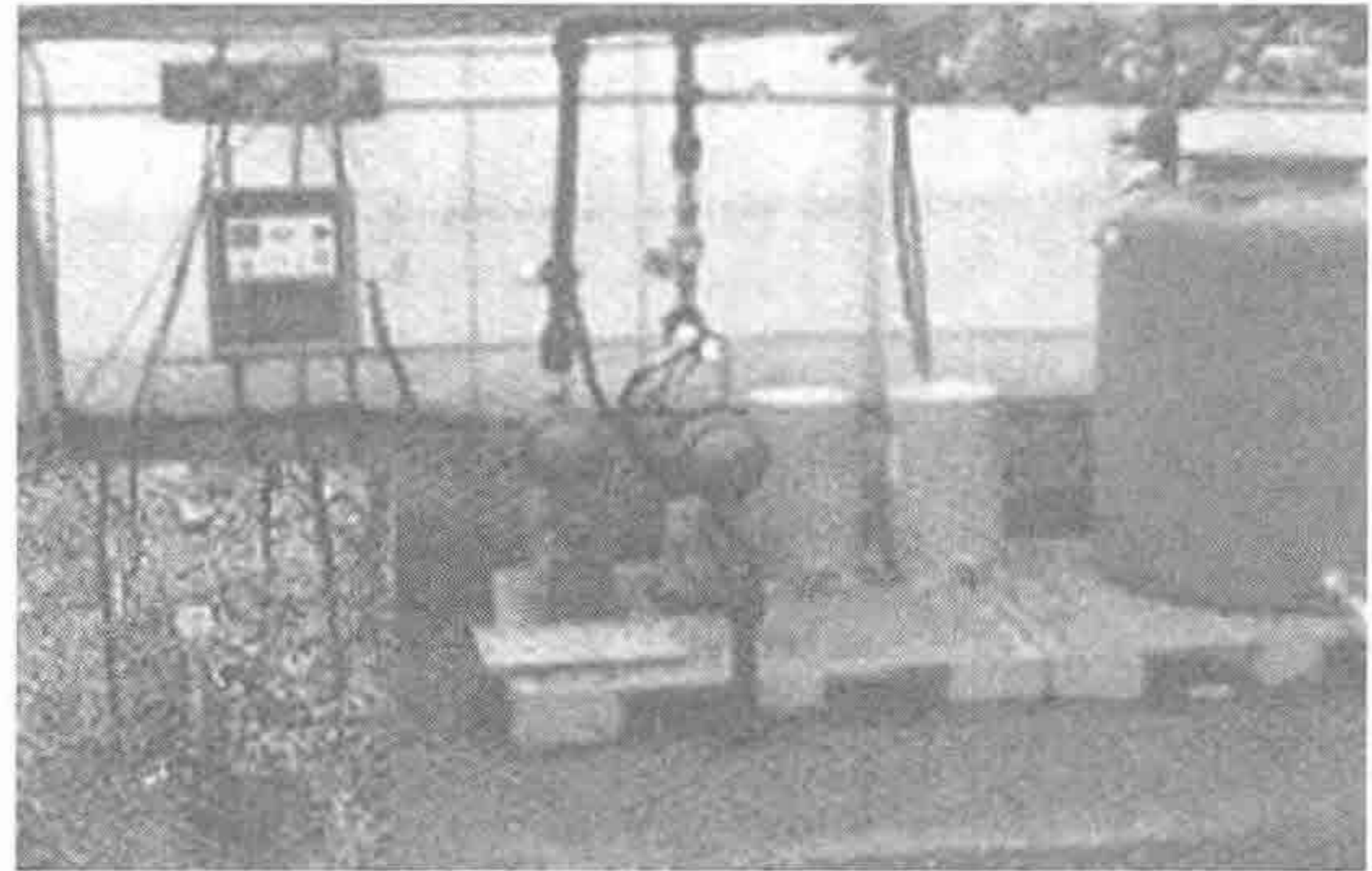
그림1. 비가림 포도원 자동관수시스템 설치
