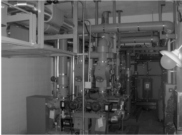
▲ 우현이앤지(주)가 시공한 옥외 공동구 기계실 배관
