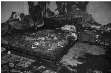
【사진 8】 방에 유류를 살포한 후 방화한 낮은 연소패턴
