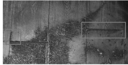
【사진 4.2】 목재 마감재의 틈새를 따라 흐른 액체가연물의 연소흔적
