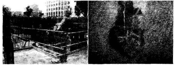
(d) 철근부식 및 콘크리트 노후화
