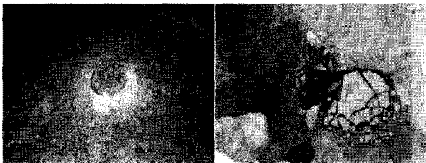
(a) 콘크리트 박리·박락
