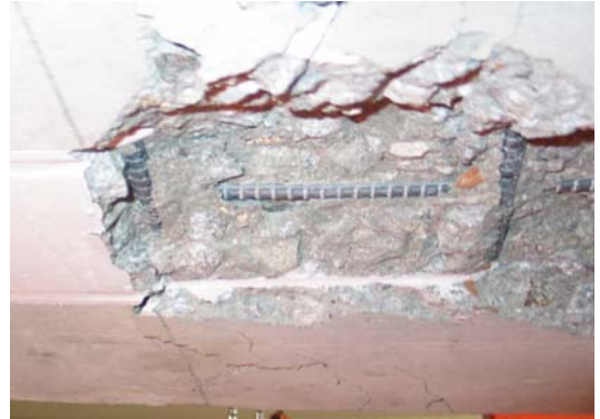
(a) 정착부 콘크리트파괴 (MIII-1 우측단)
