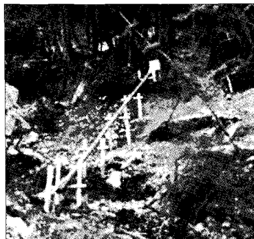
그림 11. 지반 신축계 설치
