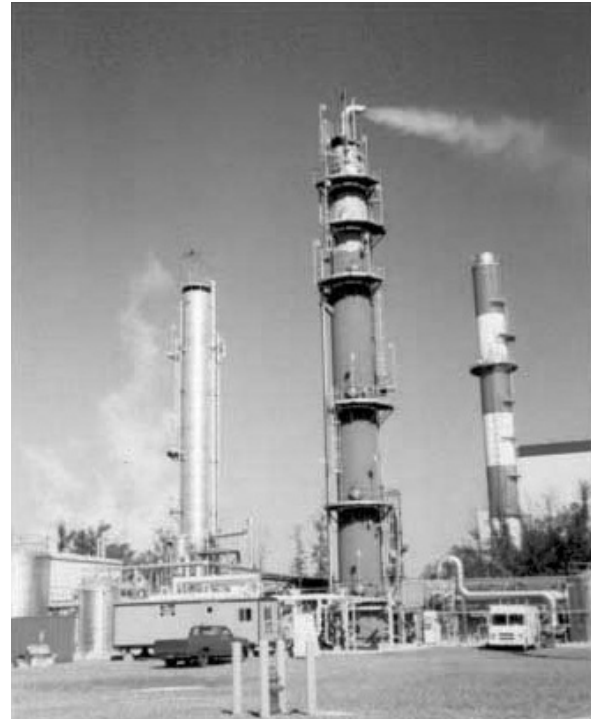
발전소 CO 2 회수 설비 (미국 컴버랜드)
