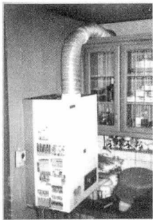
[주방에 설치된 보일러]
