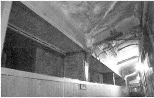
▲ 복도 입기구에는 쿨링패드를 설치하고 물을 흐르도록 고안하였다. 음압을 이용하여 강제적으로 공기를 뽑아냄으로서 돼지체표에 증발쿨링효과를 노리는 방식으로 한여름 온도하강에 효과적이다.
