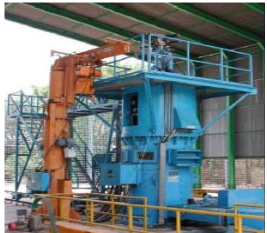
자료 : 독일 ZFL사 헬타워 소개자료, 2006년도 그림 8. 인도 힌두스탄항공사의 헬타워 설비 전경
