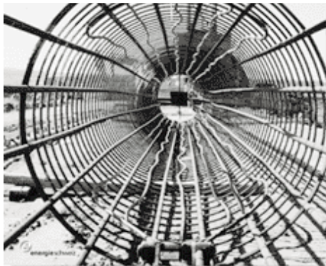
1) U튜브 투입 방식 (스위스 취리히 공항) 출전:Geothermic.ch No.40 (2006)
